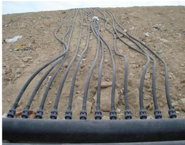
EXTRACCIÓN DE BIOGÁS
