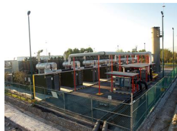
SISTEMA DE EXTRACCIÓN Y QUEMADOR DE BIOGÁS
